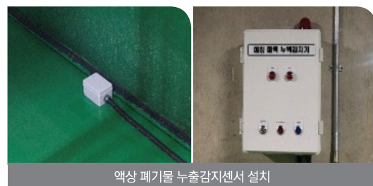
액상 폐기물 누출감지센서 설치
