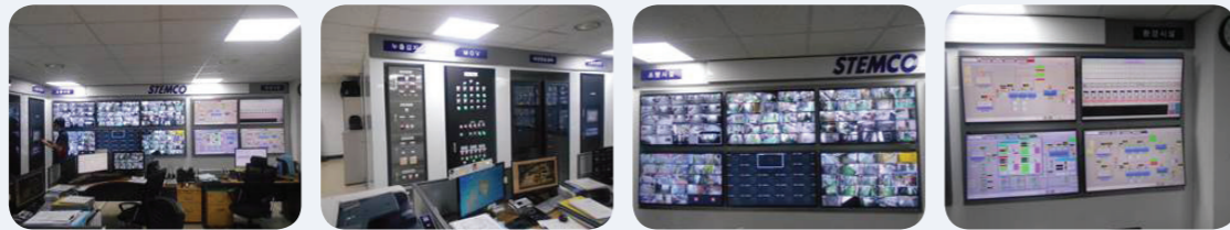
환경방재 통합센터(화학물질 누출관리, 수질자동측정, 화재감지 모니터링)
